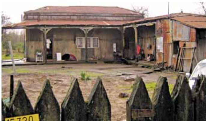
Fig. 48. Patrimonio arquitectónico en mal estado de conservación. Conjunto estación casa ferroviario. Antihue. Comuna Los Lagos.
