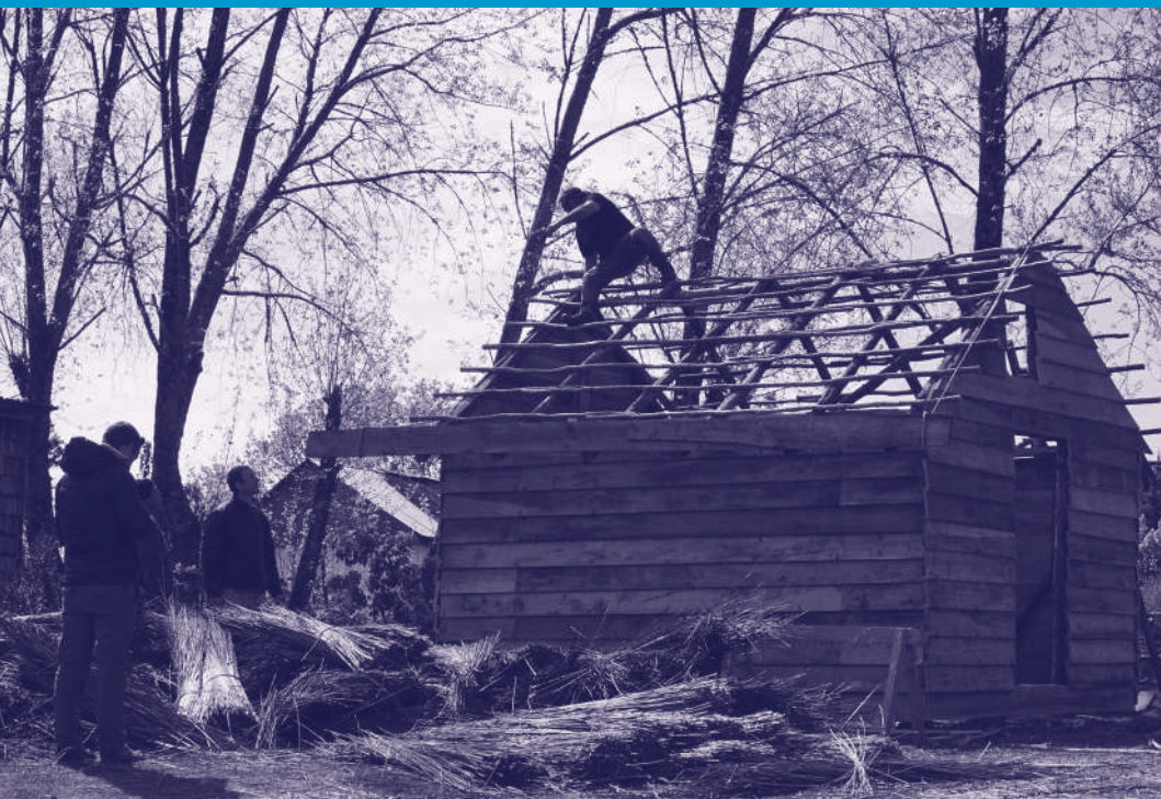
↑ IMAGEN 1 Construcción de ruka fogón huilliche mediante minga en Escuela Rural Metahue, Isla de Apiao, Archipiélago de Chiloé (2017). Autora: Paula Martínez.
